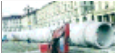
PIAZZA VITTORIO Sono entrati nel vivo i lavori per realizzare 670 posti in piazza Vittorio.
